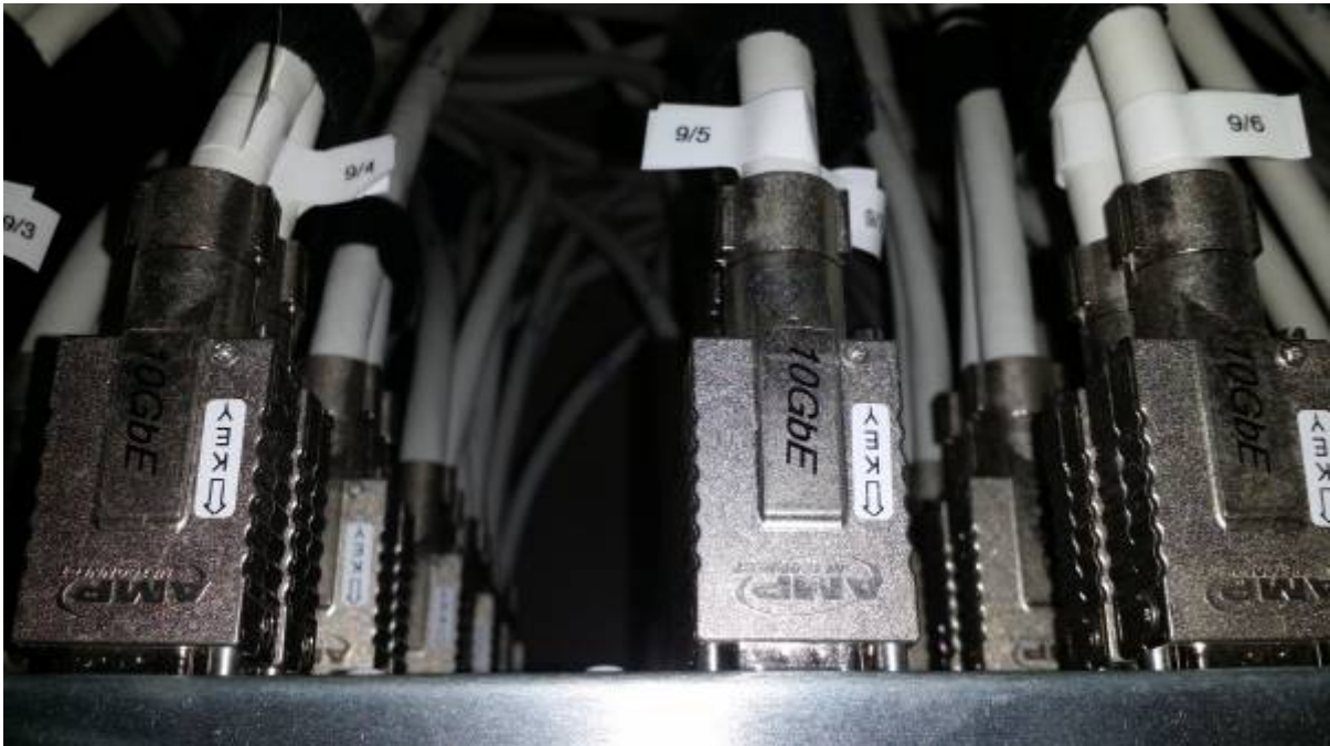
Vista posterior de las conexiones del Rack con 24 conexiones de fibra y un panel de 48 bocas a 10 Gb
